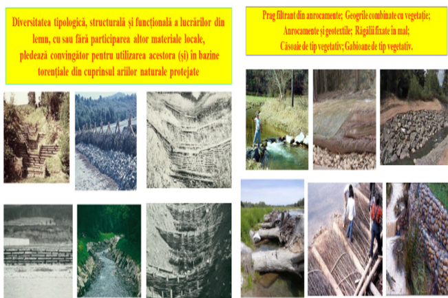
Fig. 7. Soluții prietenoase cu mediul pentru amenajarea albiilor torențiale – exemple de lucrări ecologice și materiale naturale utilizate în România (Sursa: Fototeca disciplinei de Corectarea Torenților, Universitatea Transilvania din Brașov - foto: Stelian Munteanu 1950-1970)
